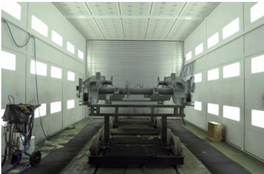
De spuitcabine in de centrale werkplaats Salzannes, 2004 (Ref. D2365-01)
